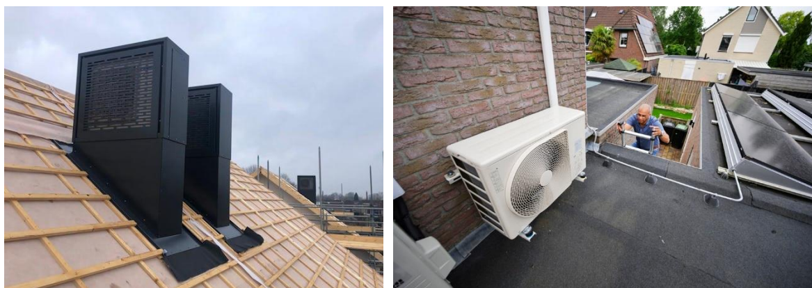
Figuur 5.1 - Voorbeelden buitenunit luchtwarmtepomp op schuin dak en aan gevel
